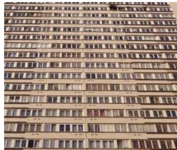
La dégradation avancée des façades constatée au DTG, constitue l'opportunité de revaloriser le patrimoine en redonnant à l'immeuble ses qualités d'origine dès lors que la modération des déperditions énergétiques rend le projet de rénovation énergétique très réaliste
